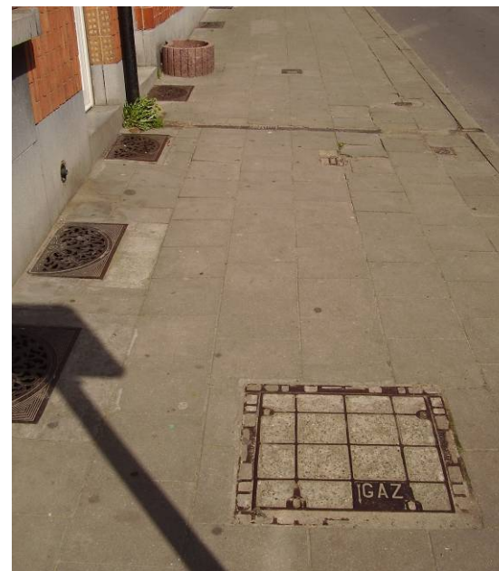
Door de slijtage van de voetpaden worden rioolputdeksels en afwateringsgoten gevaarlijk voor de voetgangers.
